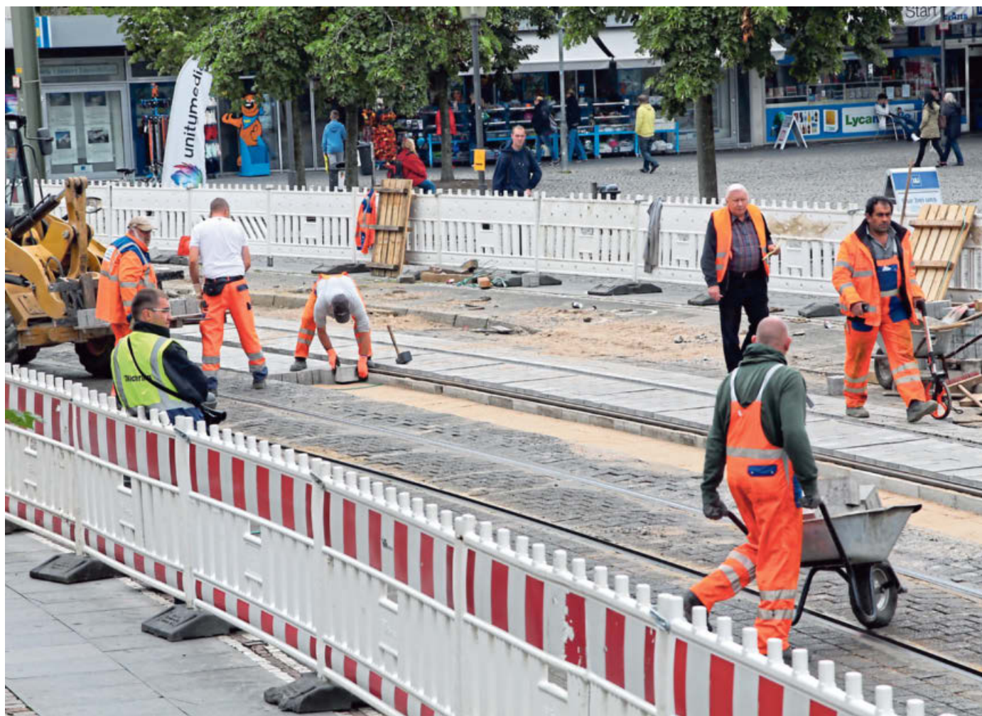
Für Brackweder gehören Gleisarbeiten und Pflastersanierungen wie hier vor vier Jahren am Treppenplatz fast schon zum gewohnten Anblick in der Hauptstraße. Die, die Montag beginnen, sollen allerdings die vorerst letzten sein – bis zum Umbau. FOTO: JUDITH GLADOW
